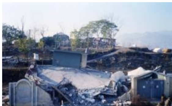
Esempio di danni
